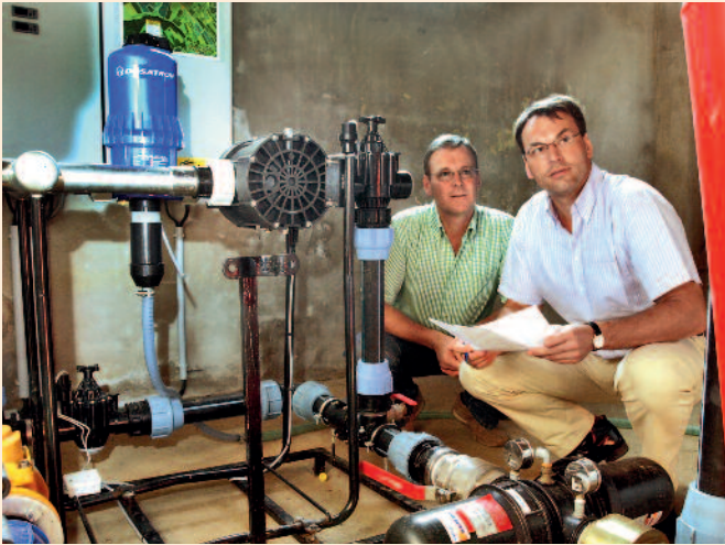
Abnahme einer Bewässerungsanlage Acceptance of an irrigation plant
