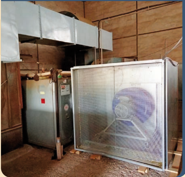
Abbildung 3: Umluftventilator (rechts) und Ansaugstutzen des Zuluftventilators (links)
